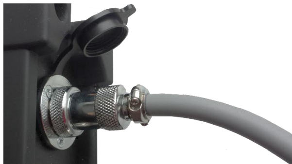
Рисунок 2.1 – Подключение высоковольтного трансформатора-держателя
